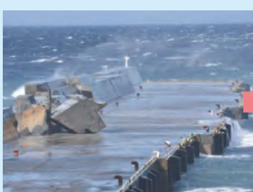
被災状況 (平成30年10月1日)
