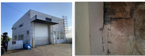
築25年が経過した現在の清掃センター 風害、塩害に加え、内部では経年劣化により焼却炉のひび割れなども頻発
